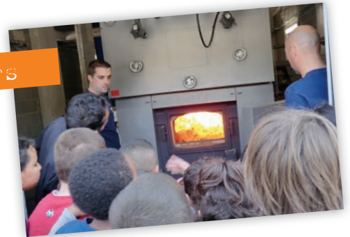
Visite de la chaufferie bois du Viguiers par les enfants des écoles du quartier
